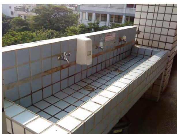
走廊洗手台裝設洗手乳
